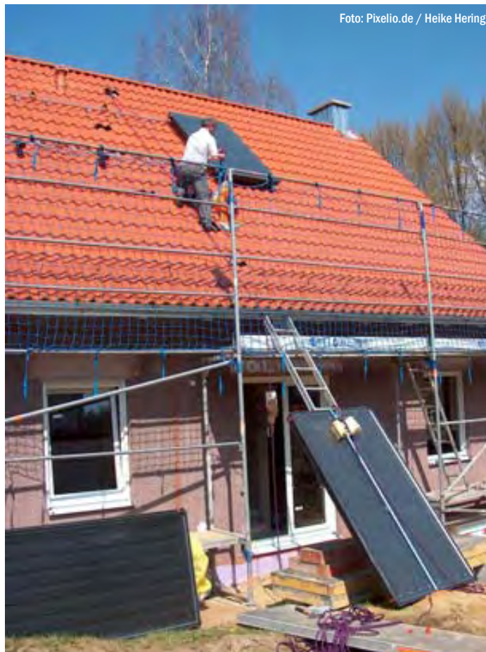
Dem Vorbild der Stadt Marburg folgend, wollen die Grünen dafür sorgen, dass zukünftig jeden Neubau eine Solaranlage zur Wärmezeugung ziert. Das schont nicht nur die Umwelt, sondern auch den Geldbeutel.-
